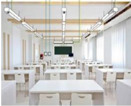
المصابيح في صفين متوازيين متعلدين مع الحائط المستخدم للسبورة مصباح خاصة للسبورة مفتاح التحكم الرئيسي للإضاءة العامة مفتاح للتحكم بالإضاءة خاصة للسبورة
